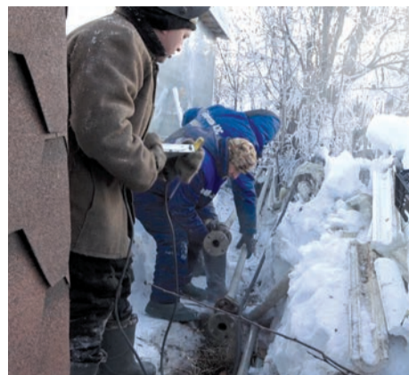
устранения аварии. В шесть вечера авария устранена, электроснабжение домов восстановлено.
